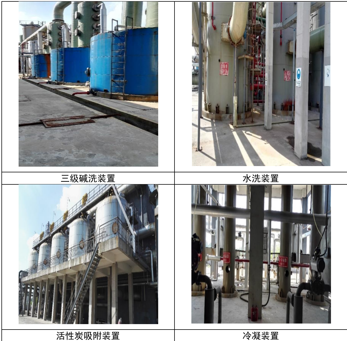
图 7.1-3 废气处理装置
